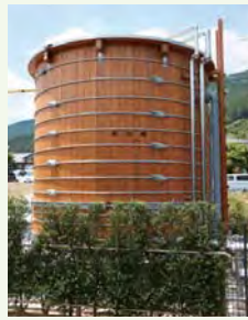
間伐材の杉でつくった受水槽。強度もあり、衛生的にもいいそう。
