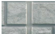
施工1~2年で発生する薄層のみ出し部の白化
