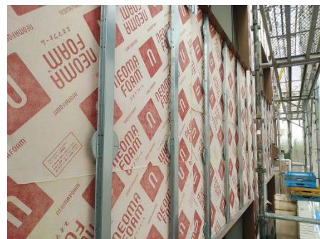
断熱材の施工後、不陸調整用のベースディスクが取り付けられ、その上に金属胴縁を施工。
