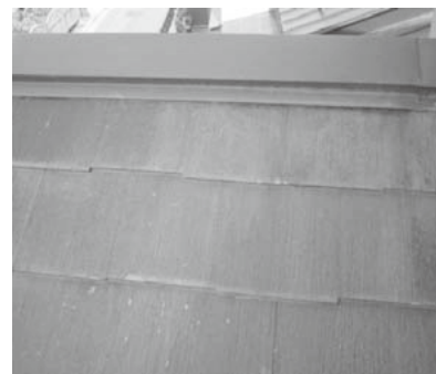
【屋根葺材のコケ】
