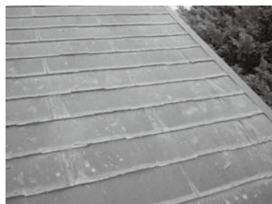
【屋根葺材の凍害】
