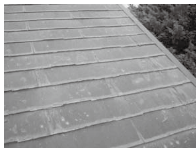
【屋根葺材の凍害】
