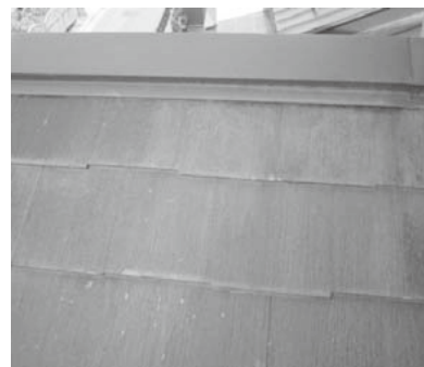
【屋根葺材のコケ】
