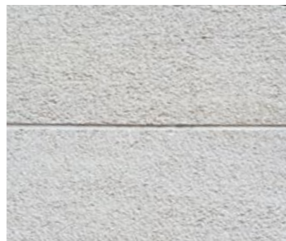
化粧目地の施工例 [1・2階上下接合部(サイディング1・2段目化粧目地仕様)]
