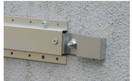
金属胴縁15一般部用 (KN2045) を被せて、平頭ねじ (KN65) を使用し留め付けてください。アタッチメント部以外はRC用ビスを使用し、RC躯体へ留め付けてください。
