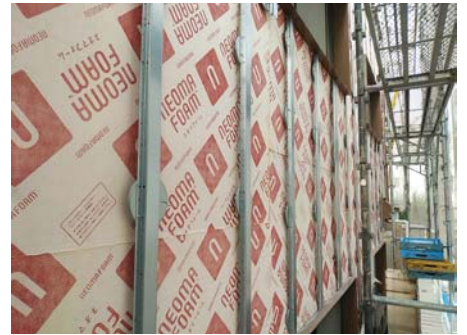
断熱材の施工後、不陸調整用のベースディスクが取り付けられ、その上に金属胴縁を施工。
